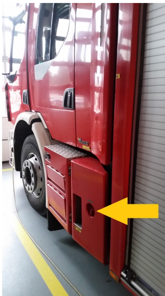
Rys. 95. Główny wyłącznik prądu w okolicy umieszczenia akumulatorów
